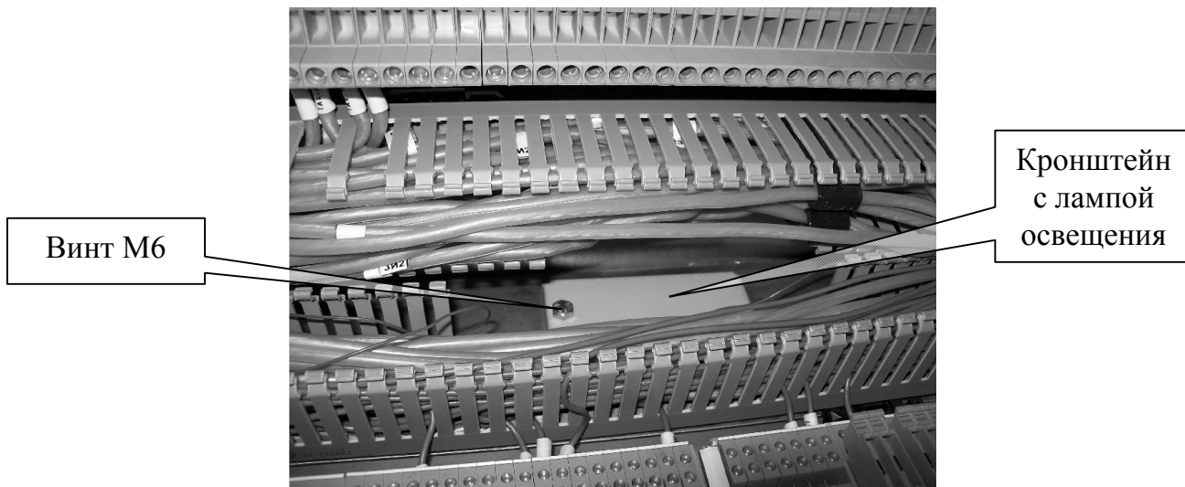
Рисунок 65 – Доступ к лампе освещения отсека ВЭ через релейный шкаф
